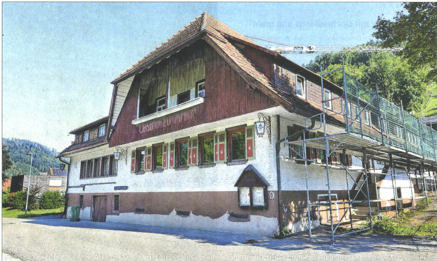
Der „Gasthof Krone“ im unteren Kirnbachtal wird vom Architekten Hardy Happle grundlegend saniert. Sein Büro mit 18 Mitarbeitern ist bereits eingezogen. Neu dazu kommen eine Vesperstube sowie fünf Mietwohnungen.
