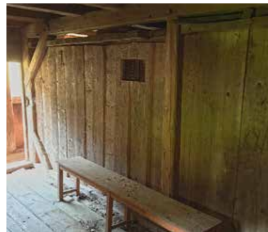
Abb. 35: Knechtekammer im Speicher des Sumhofes, Wolfach-Kirnbach (17. Jh., vergrößert um 1800). Gut zu sehen: die massive Bohlenkonstruktion der beiden Kornkästen. Aufnahme 2015
